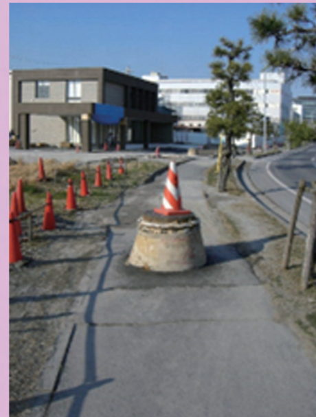
液状化によるマンホールの突出
